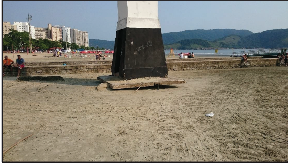
Figura 5-57. Novamente a base do farol exposta decorrente de intenso processo erosivo, em outubro de 2015.
