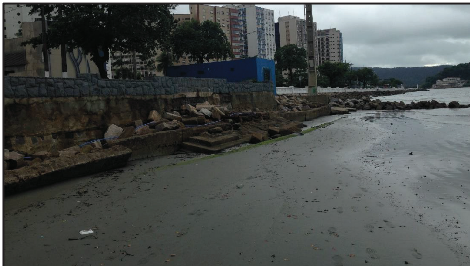
Figura 5-53. Adutora da SABESP coberta por areia depositada artificialmente na região da Ponta da Praia.
