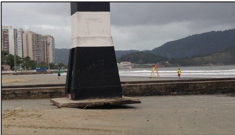
Figura 5-55. Base do farol totalmente exposta devido ao processo erosivo junto ao perfil STOS20, em agosto de 2015.
